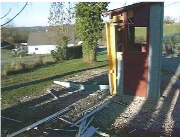
Détérioration d'un abris bus
